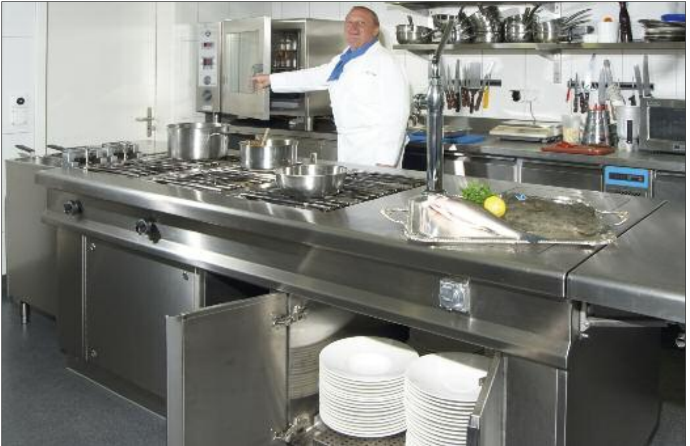
So sieht die Kompakt-Küche in der «Fischerstube» von Weesen aus: Im Mittelpunkt der gasbetriebene Kochherd und in der Ecke der elektrisch betriebene MKN-Kombidämpfer «HansDampf gold» 6 x 1/1 GN, der von der G. Hammer AG (Chur, Rheineck) geliefert wurde.
